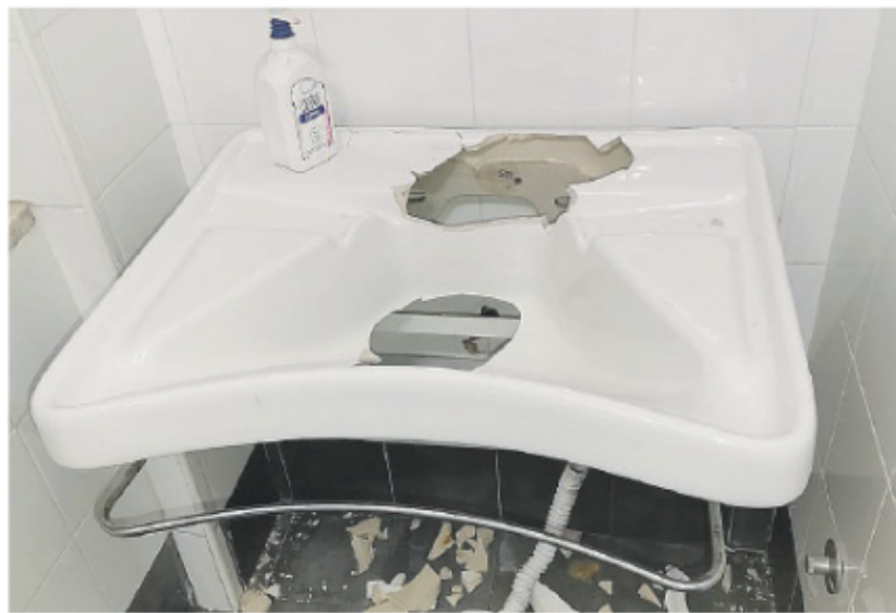
Un lavandino già depredata dai ladri
