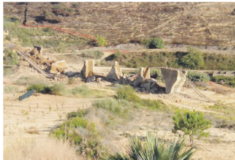
Il ponte ferroviario demolito
